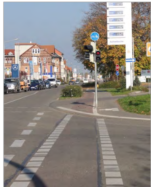
Baulich angelegter Radweg (fehlende Nullabsenkung) in Arnstadt, Ichtershäuser Straße Quelle: C. Gerbig.
